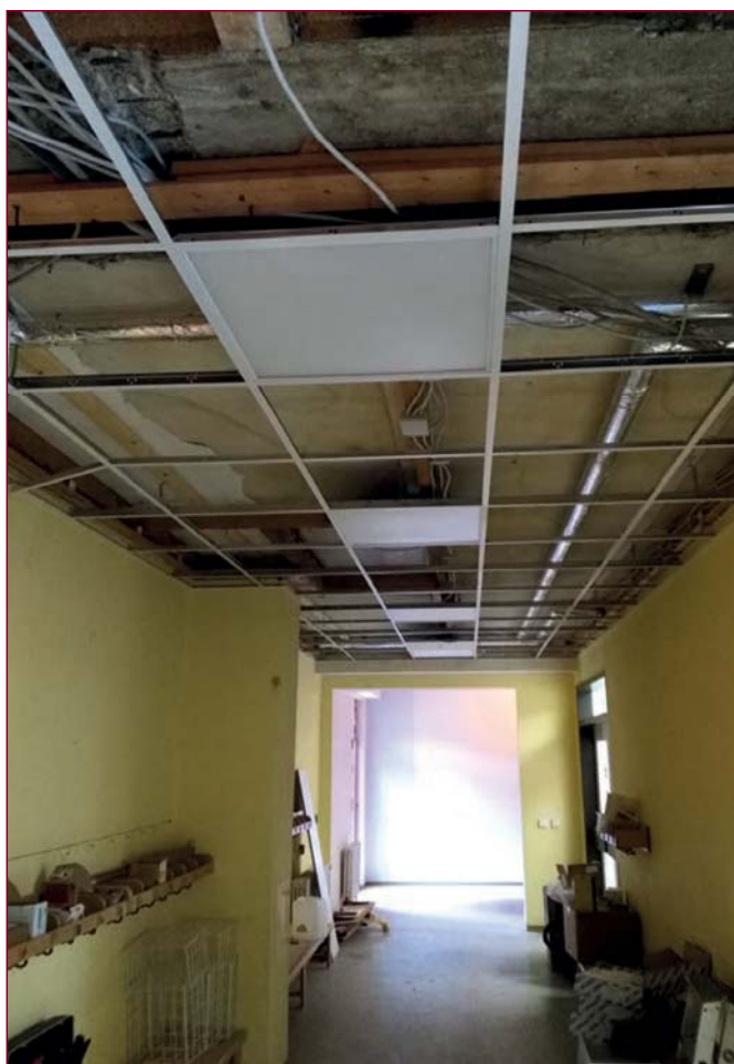
Um an die Wasserleitungen zu kommen, mussten die Decken im Kindergarten geöffnet werden. Diese werden in diesem Zuge ebenfalls erneuert.
